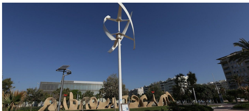
5-1. irudia: Malagako kale-argietan instalatuta dagoen aerosorgailua.
