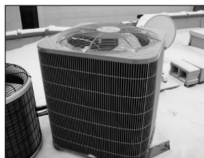
Sistemas de acondicionamiento del aire
